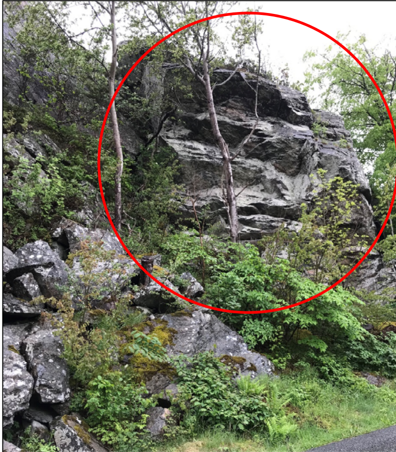
Bild 7. Överhäng med stabilitetsproblem i södra delen av bergslänten.
