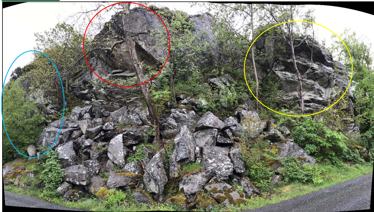
Bild 1. Bergslänt vid Tjällviksvägen med rasmassor i nederkant. Bilden är sammansatt av flera bilder vilket kan förvränga motivet något.
